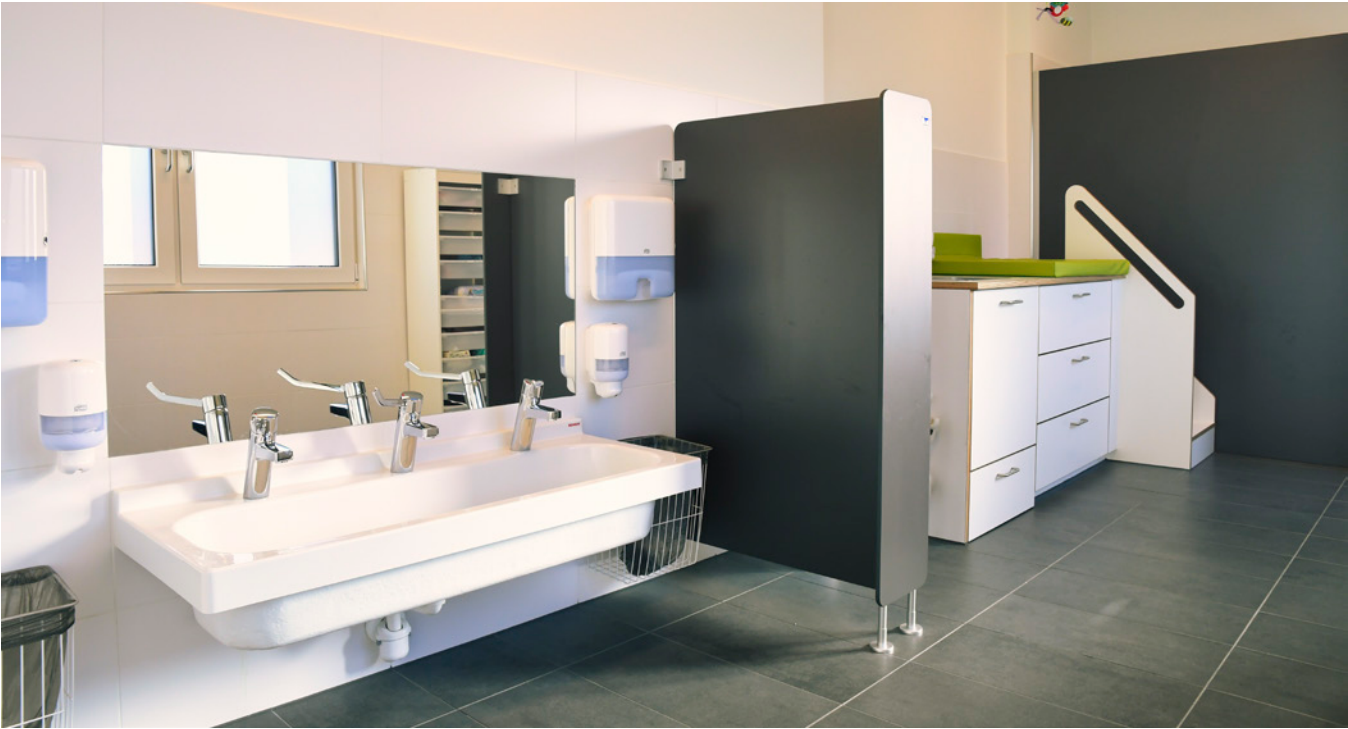
Instalaciones sanitarias para los niños
